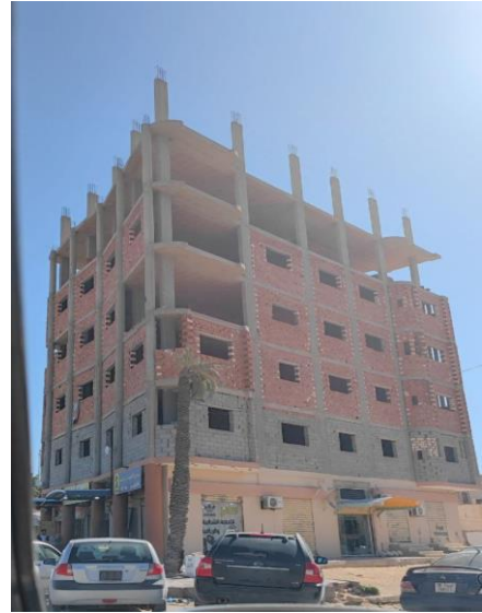
صورة (5) التجاوز في طوابق المباني
